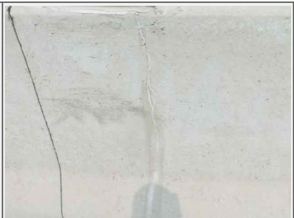
내포교(영천) S2 방호벽 균열부백태(0.3mm이상)
