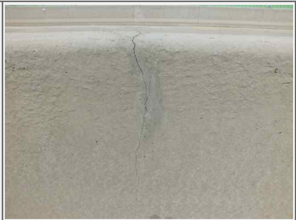
내포교(상주) S2 중분대 균열(0.3mm이상)
