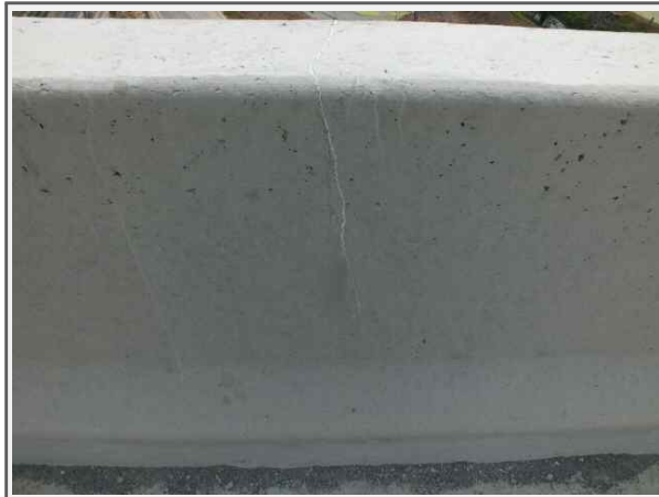
내포교(상주) S1 방호벽 균열부백태(0.3mm이상)
