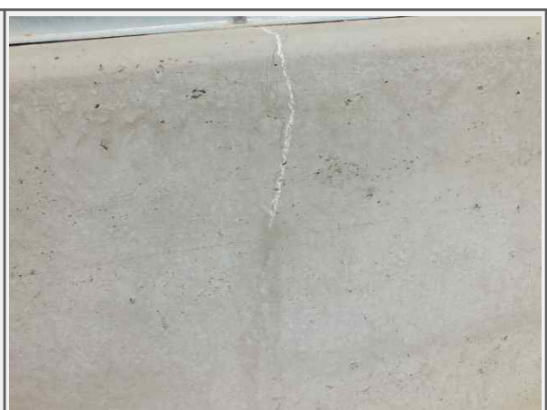
내포교(영천) S4 방호벽 균열(0.3mm이상)
