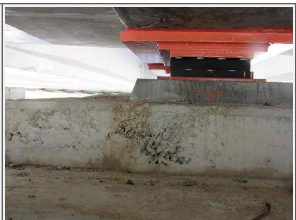
내포교(영천) P3 받침콘크리트 재료분리
