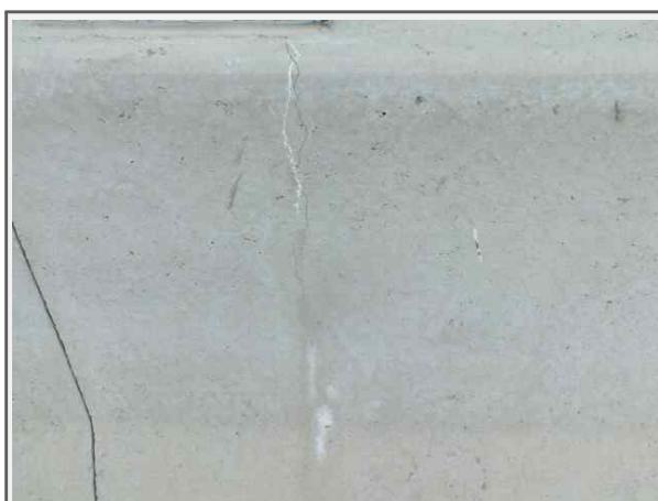
내포교(영천) S3 방호벽 균열부백태(0.3mm이상)
