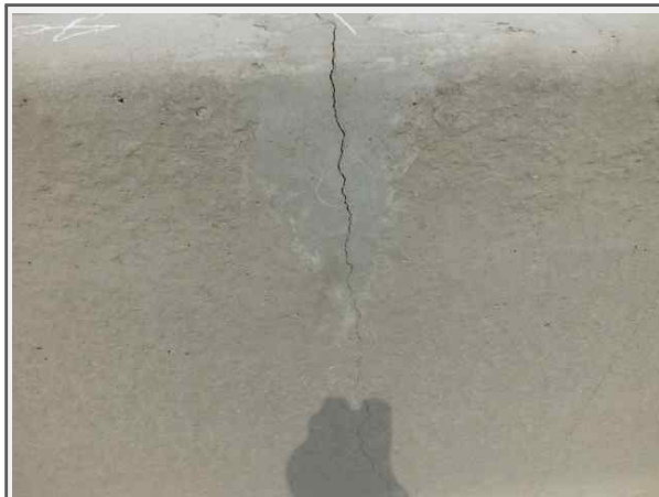
내포교(상주) S4 중분대 균열(0.3mm이상)
