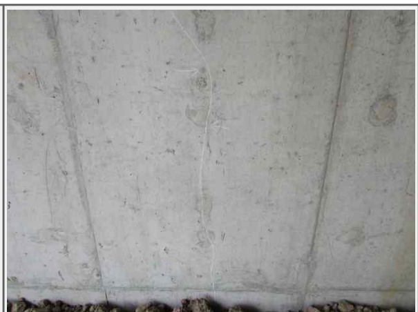
내포교(영천) A1 벽체 균열 (0.3mm미만)
