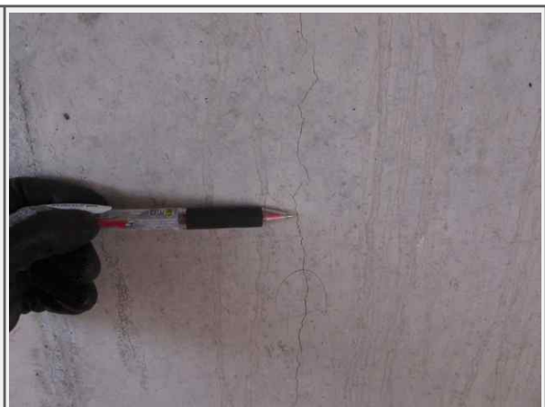
내포교(상주) A2 벽체 균열 (0.3mm미만)
