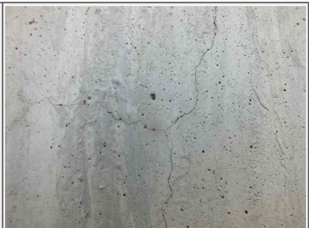
내포교(영천) P1 기둥부 망상균열
