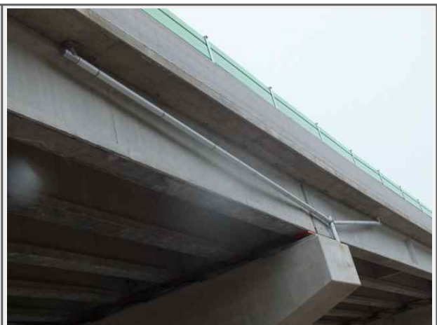
내 용 내포교(영천) 배수관
