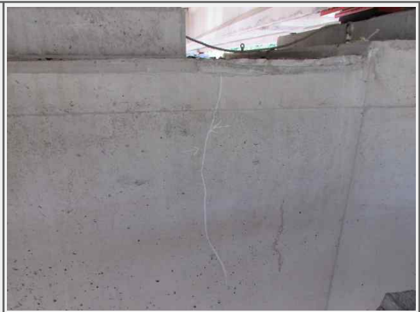
내포교(상주) P2 코핑부 균열(0.3mm미만)
