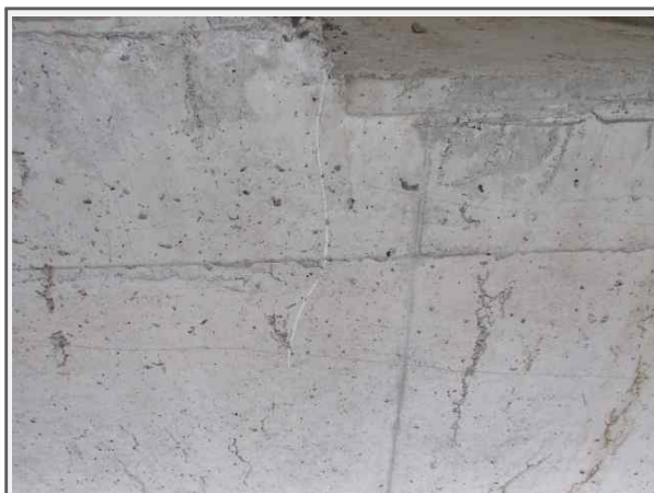
내포교(영천) P2 코핑부 균열(0.3mm미만)
